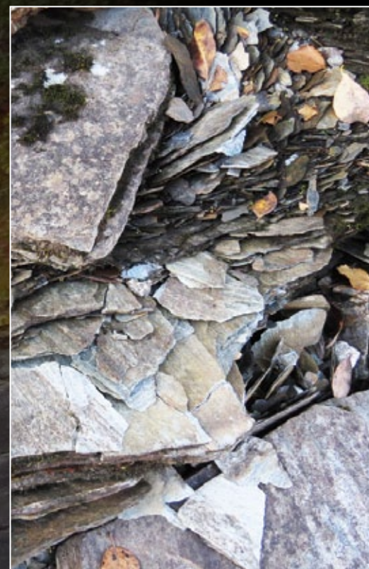
Vinterns återkommande frostsprängningar bryter sönder skiffern.
